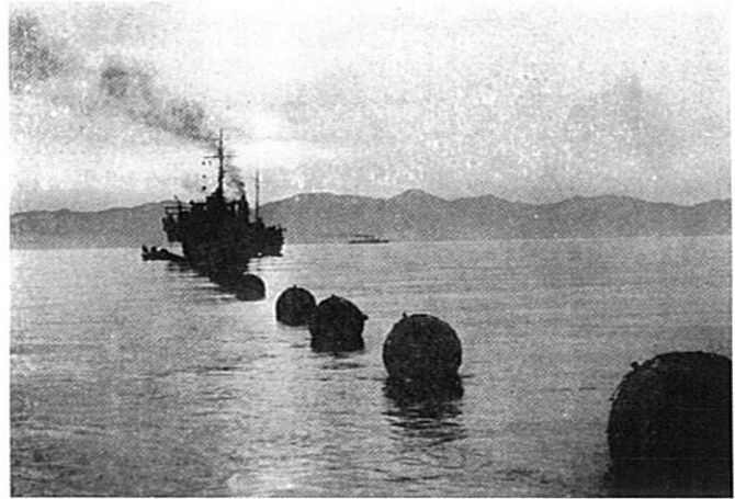
▲戦後唯一の大型敷設船「釣島」が荒廃した海底ケーブルの復興に。 「津軽海峡、山崎～当別」に、1.6mm8対無装荷搬送ゴム鉛被海底ケーブルの敷設に いどむ「釣島丸」
